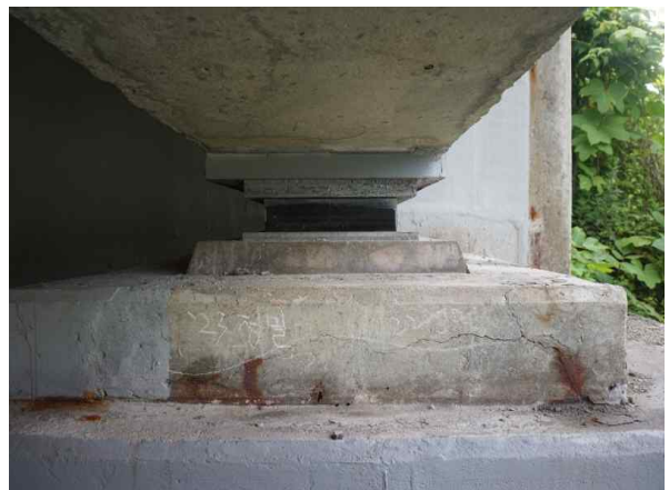
받침콘크리트 박리/철근부식 A1 SH1
