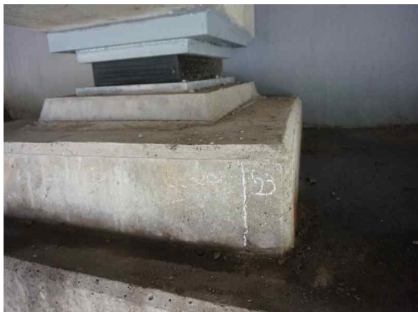
받침콘크리트 균열(0.3mm미만) A1 SH3
