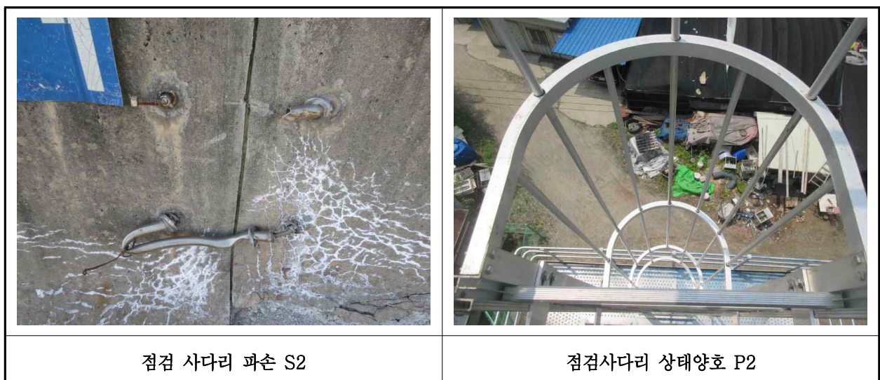
【사진 4.3.24】 교량 점검시설 손상현황
