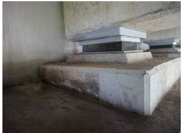
받침 콘크리트 박리/철근부식 A1 SH5
