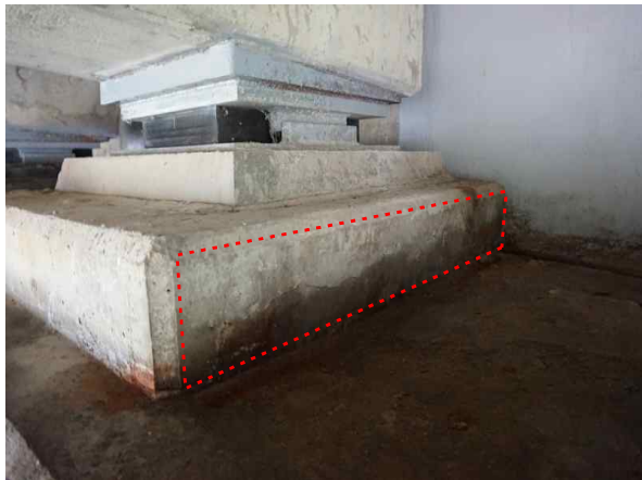
받침콘크리트 박리/철근부식 A1 SH6
