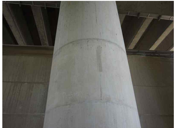
교각 망상균열 P1
