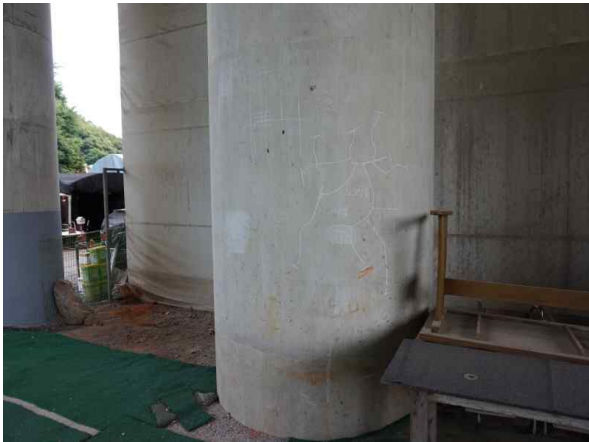
교각 망상균열 P1
